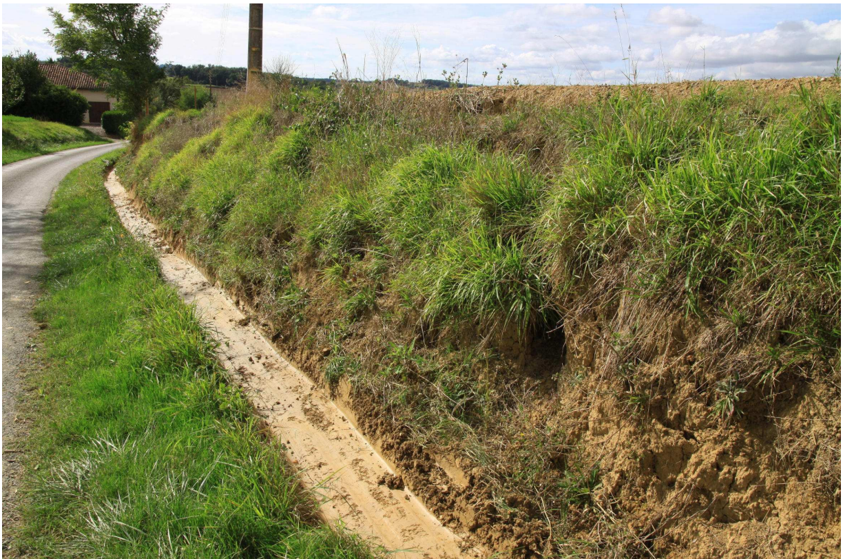
Figure 14 : La pente trop importante du talus et l'absence de haie vont entraîner une importante érosion du talus à chaque forte pluie, lessivant ensuite des matières en suspension jusque dans les cours d'eau © SIRE Conseil
